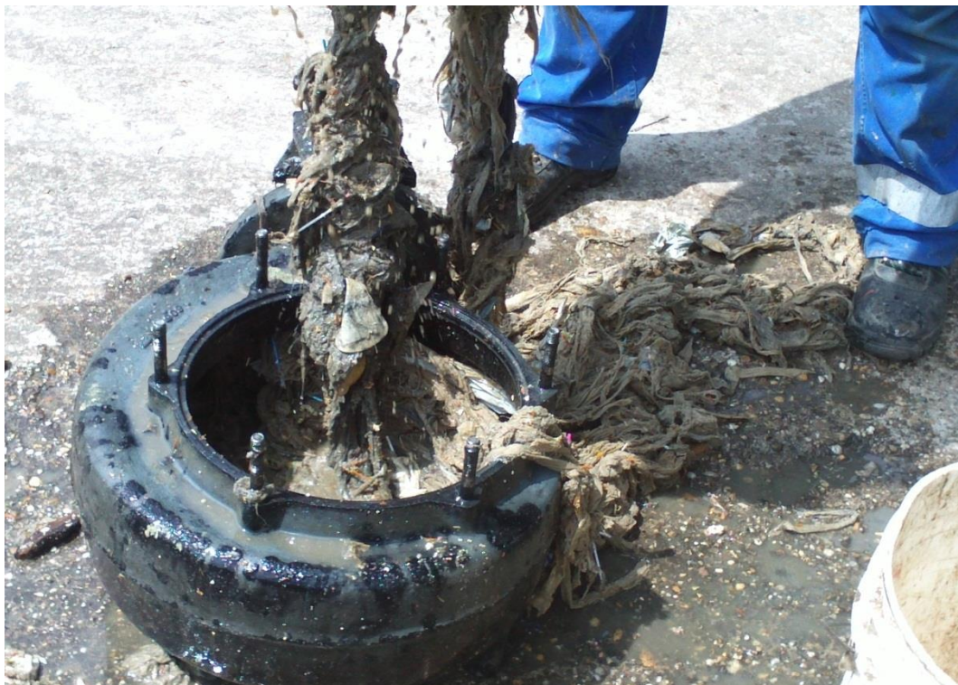
átelő szivattyú meghibásodása szálas anyag miatt
